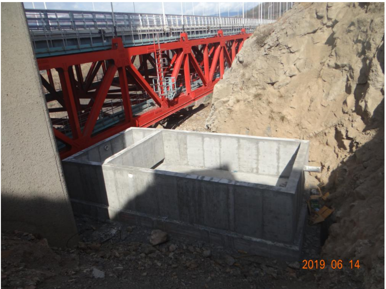
图 7-7 葫芦口大桥事故池
