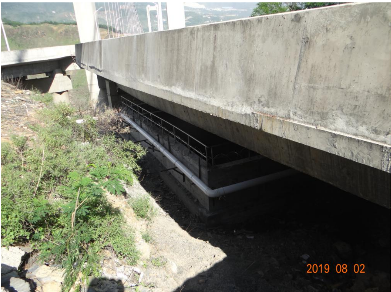
图 7-6 葫芦口大桥事故池
